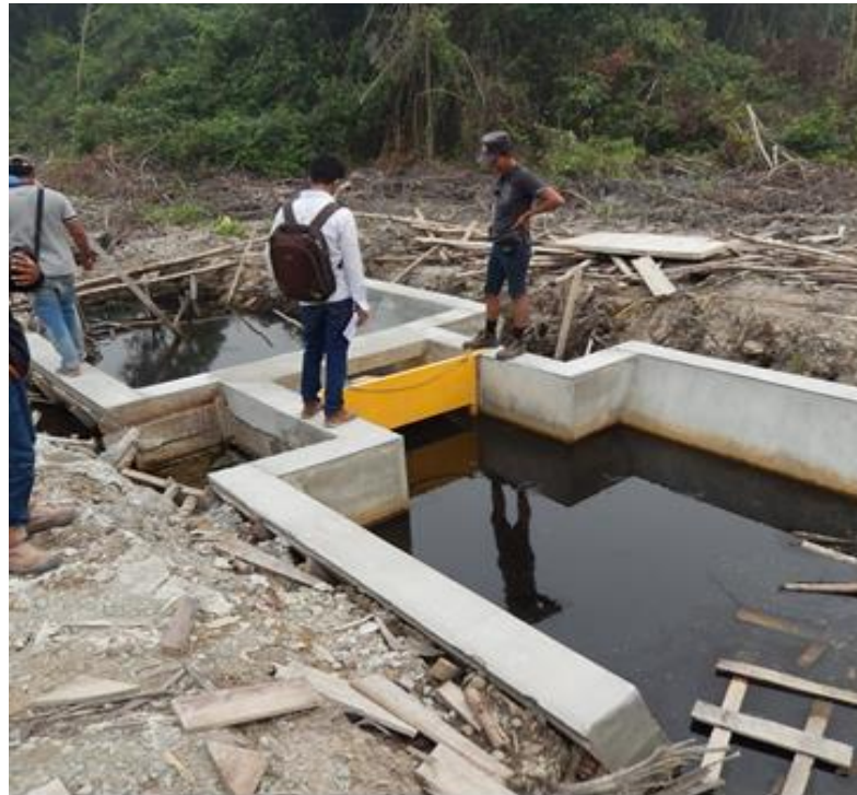
Gambar 2.22 Percobaan Pintu Air
